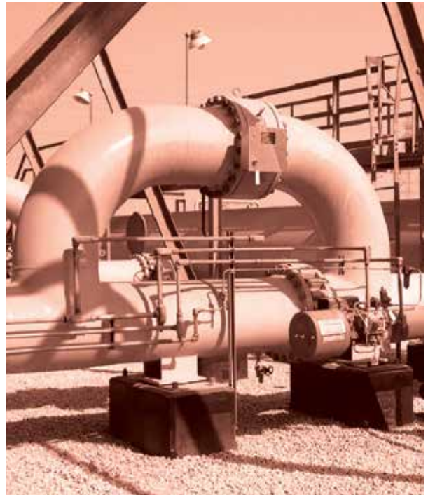
Válvula de alivio pivotante instalada como derivación en línea para controlar la válvula en un sistema de antorcha de gas
